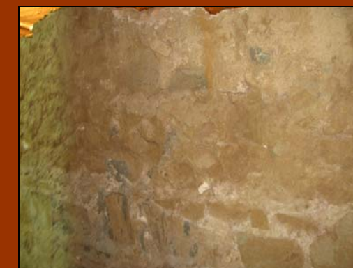
2. Incrustació de terres en les estructures.
