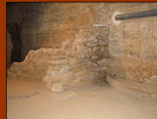
8. Descohesió del morter i desplaçaments.
