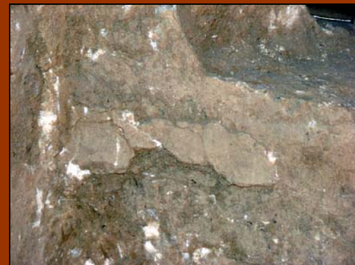
7. Descohesió dels arrebossats dels murs.
